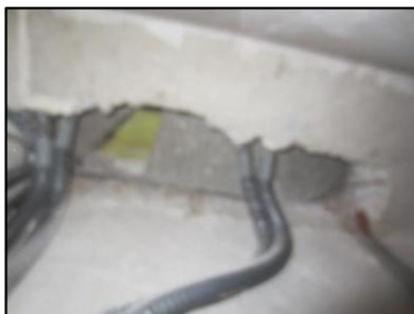
Photo N° 1287 AMIANTE CIMENT - -placards elec rdc à +5 Plafonds Plaques planes (Fibres-ciment)
